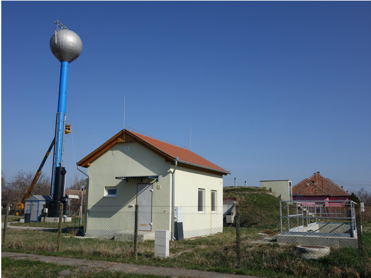
A mezőhéki vízműtelep
